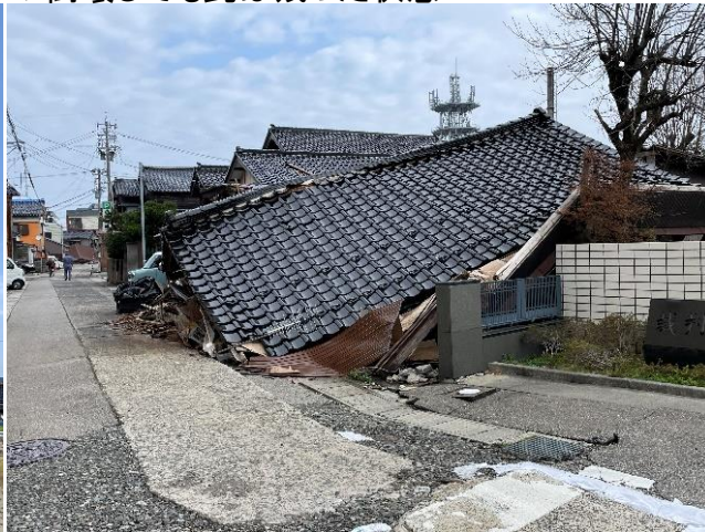
▼倒壊しても瓦は残った状態
